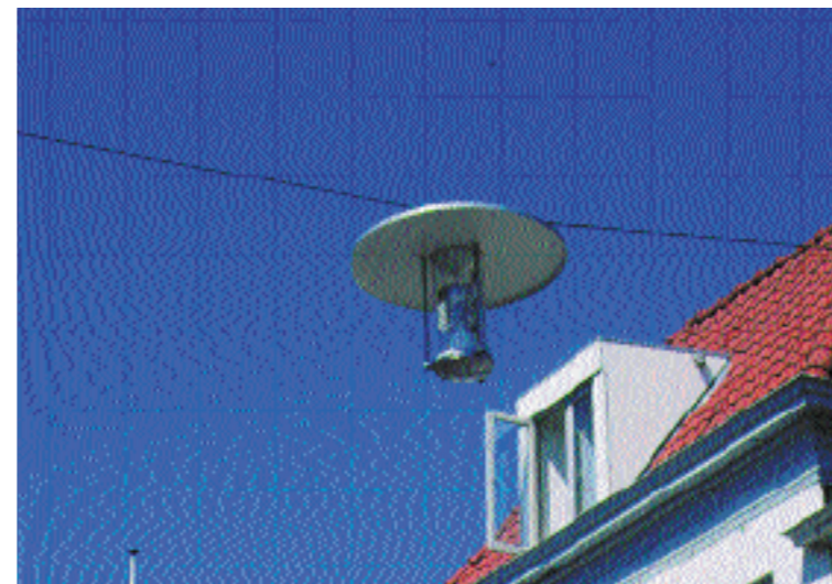
hangende verlichting in hoofdassen
